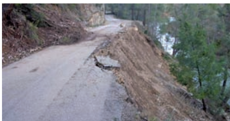
Estado de las carreteras del CRA Sierra del Segura.
